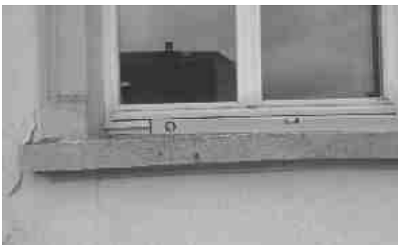
Fensterbänke knicken einseitig ab.
