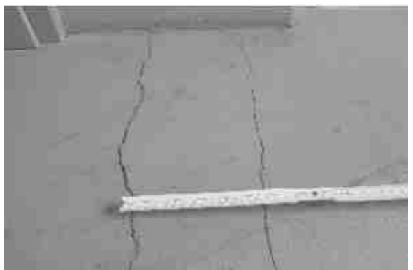
Die Betondecke im Treppenhaus bricht auseinander.
