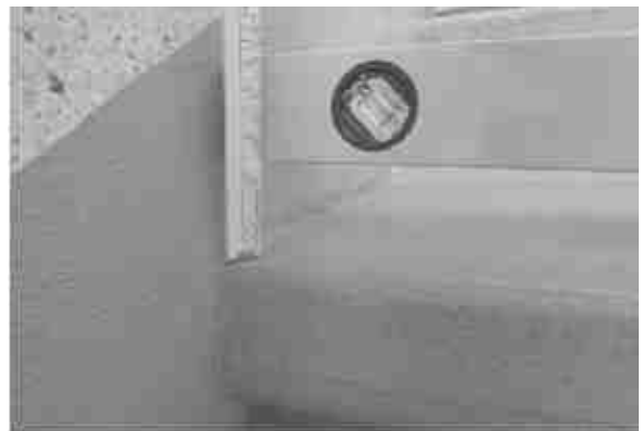
Das Treppenhaus hat sich extrem einseitig gesenkt.
