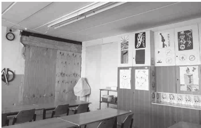
Foto: Klassenzimmer mit Durchbruch
